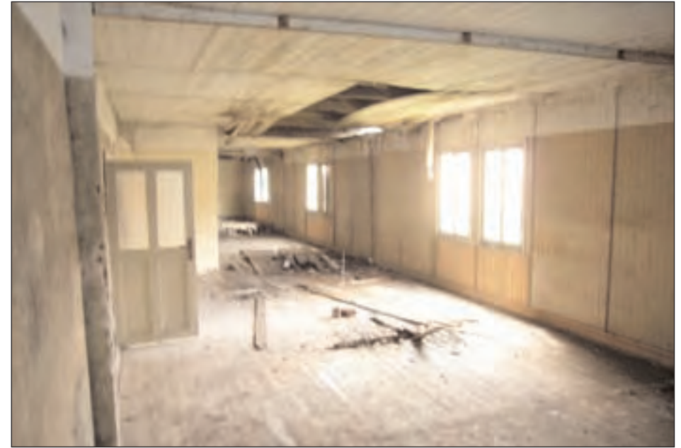
Unsanierte Boden- und Deckenbereiche im Innenraum einer ehemaligen Unterakunftsbaracke
