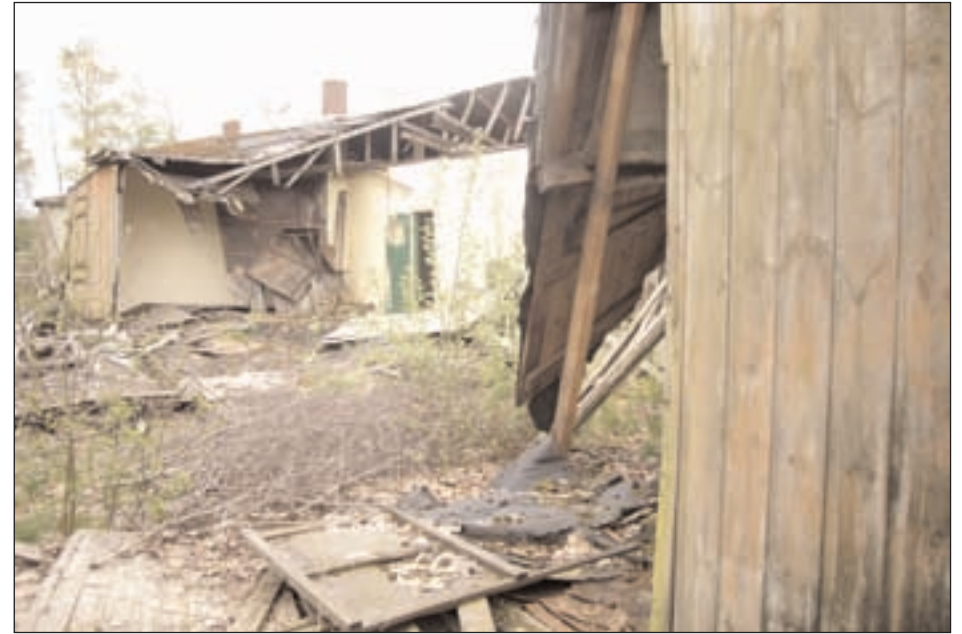
Ehem. Unterkuftsbaracke „z2“, bis auf die Giebelseiten dem „kontrollierten Verfall“ überlassen
