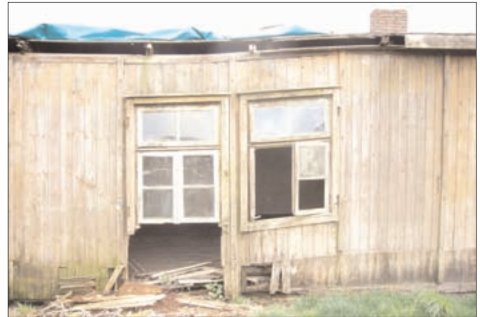
Zeitspuren am ehemaliger Unterkunftsbaracke vor der Sanierung
